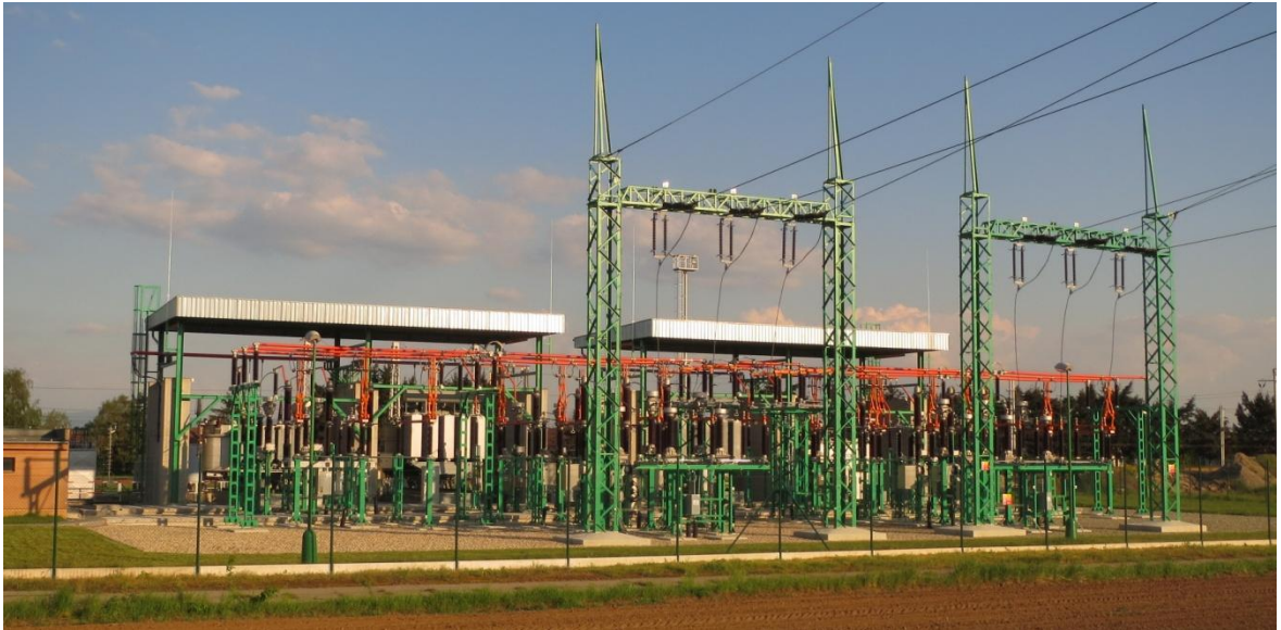
Obr. 22 Trakční transformovna pro napájení železniční tratě
