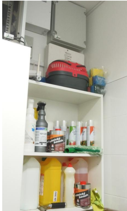
Obr. 13 Stav v technické místnosti. [Foto autor]
