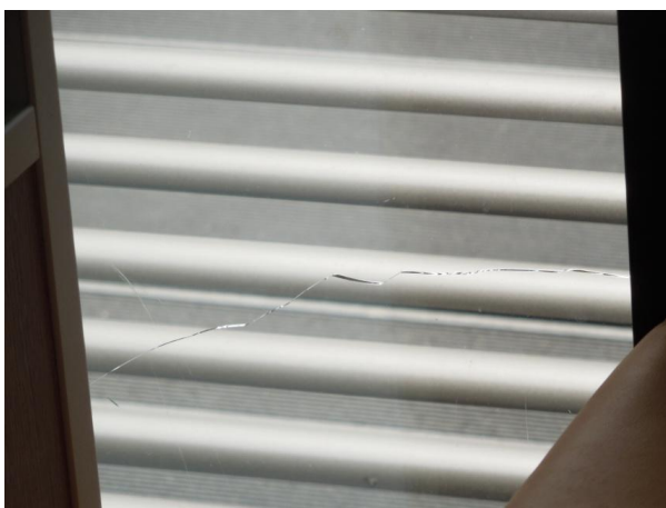
Obr. 10 Prasklé sklo ve školce. [Foto autor]
