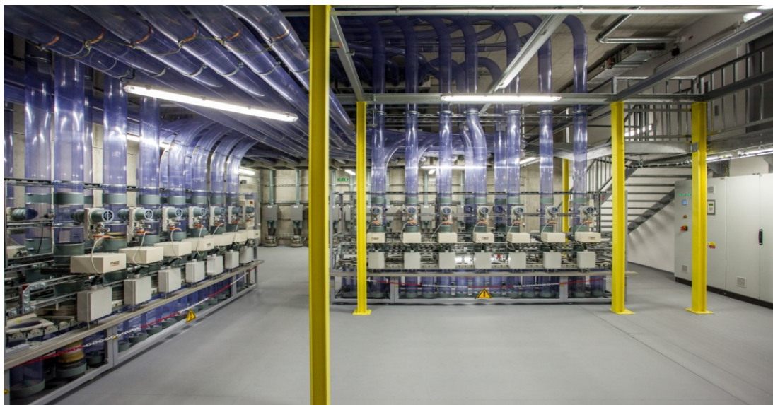
Obr. 10 Centrála potrubní pošty (interní zdroj)
