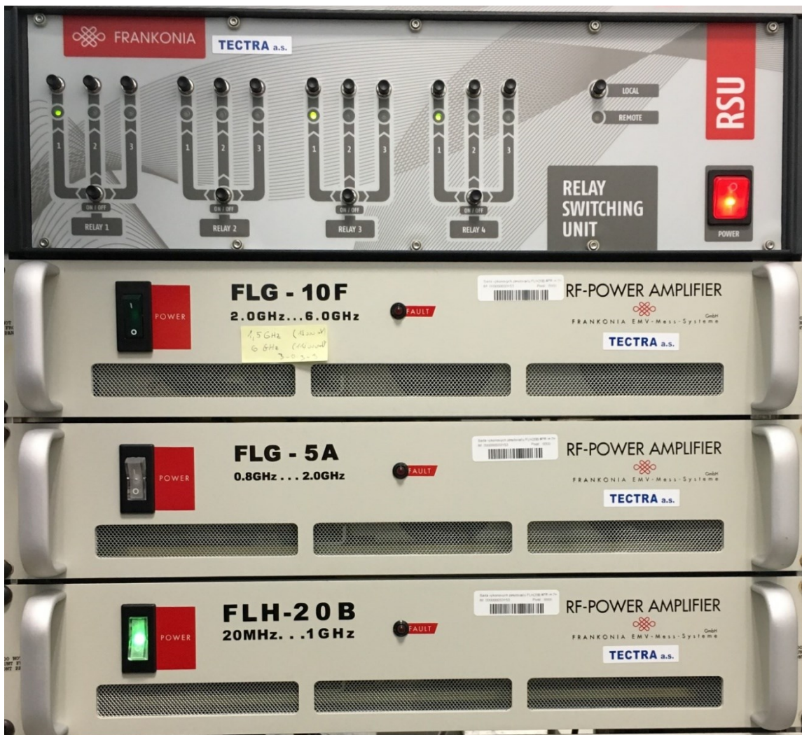
Obr. 33. Zesilovače fy. FRANKONIA spolu s reléovým spínacím panelem RSU
