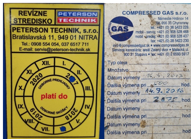
Obr. 47: Revízny štítok a evidencia servisu zariadenia [zdroj: autor]
