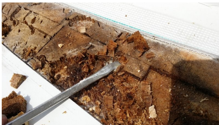
Obr. 28: Vodou poškozené balsové jádro lodní paluby [44]
