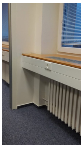
Obr. 19: Podparatová lišta vedoucí elektro instalace.
