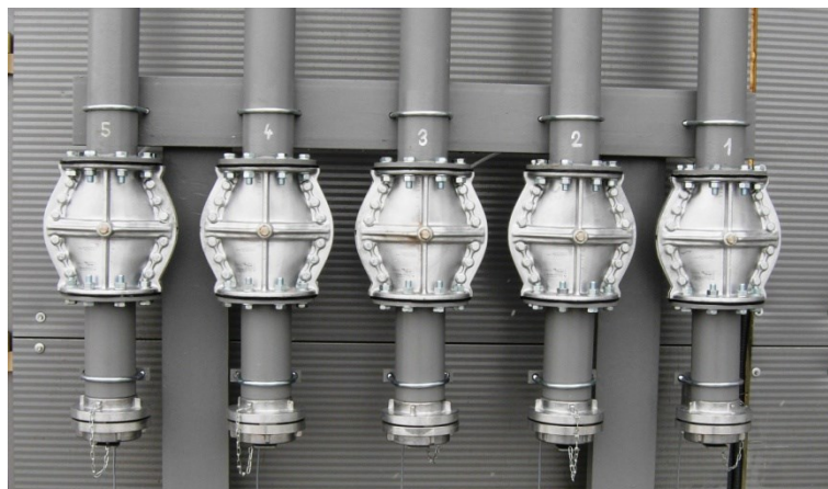
Obr. 5. Uzavírací ventily plnicího potrubí [3]
