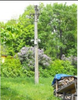
Hlásič č. 19 - č. sloupu 37
