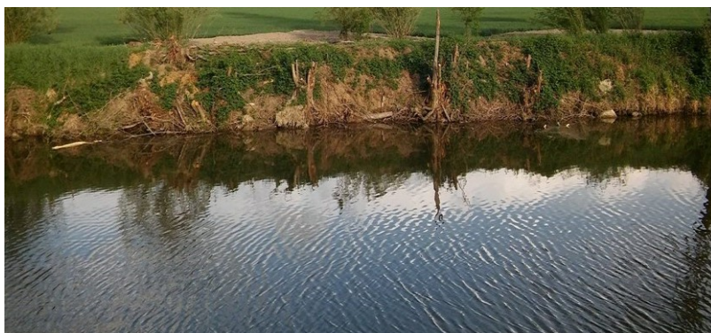
Obrázek 8 Zničené porosty a břehy na Bařově kanálu [Zdroj: autor]
