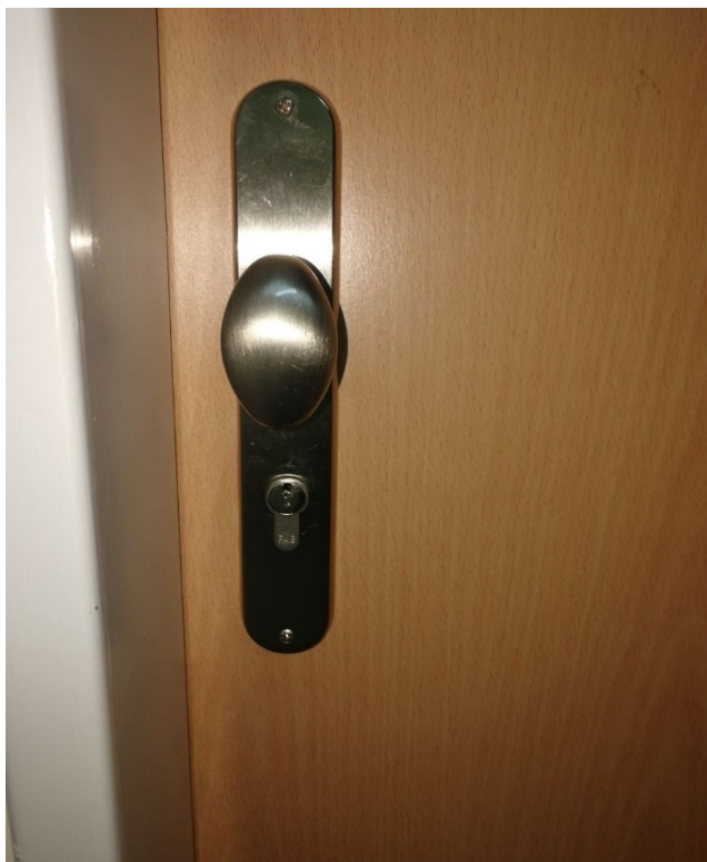
Obr. 12. Klika a zámek dveří serverovny [25]
