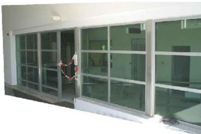
Obr. 23. Prosklená stěna s bezpečnostními skly. [29]
