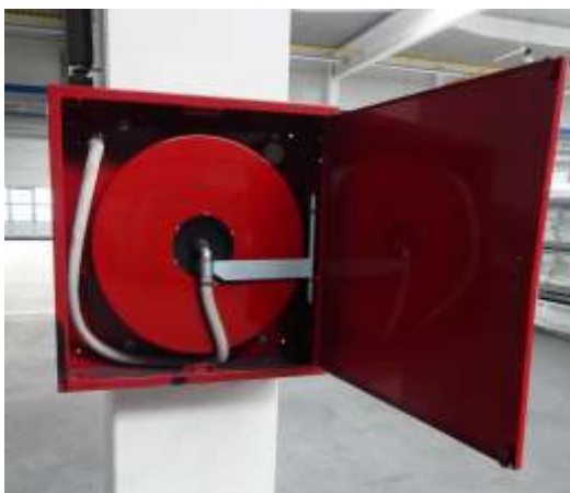
Obr. 30. Požární hydrant (vlastní fotografie)
