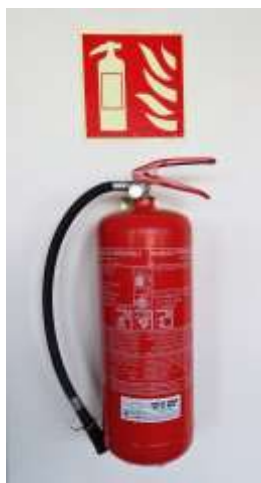
Obr. 31. Hasící přístroj (vlastní fotografie)
