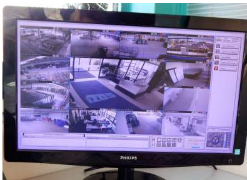
Obr. 26. Online sledování kamer na monitoru na vrátnici (vlastní fotografie)
