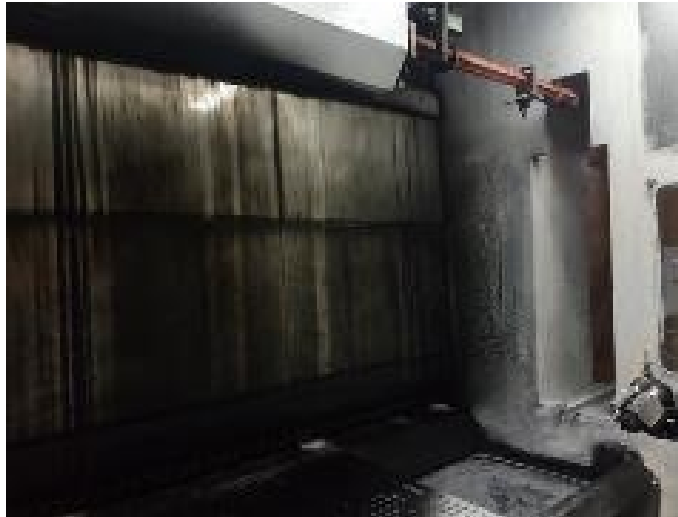
Obr. 11. Splachová stěna před čištěním (vlastní zpracování)
