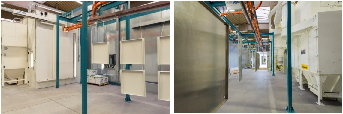
Obr. 40. Prostor v okolí linky (vlevo – výstup z ruční práškovací kabiny, vpravo – vstup do automatické práškovací kabiny)
