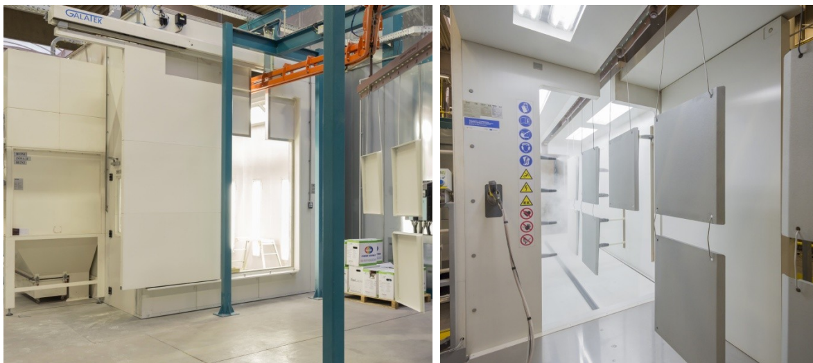
Obr. 58. Lakovací kabiny (vlevo – kabina ruční, vpravo – kabina automat)
