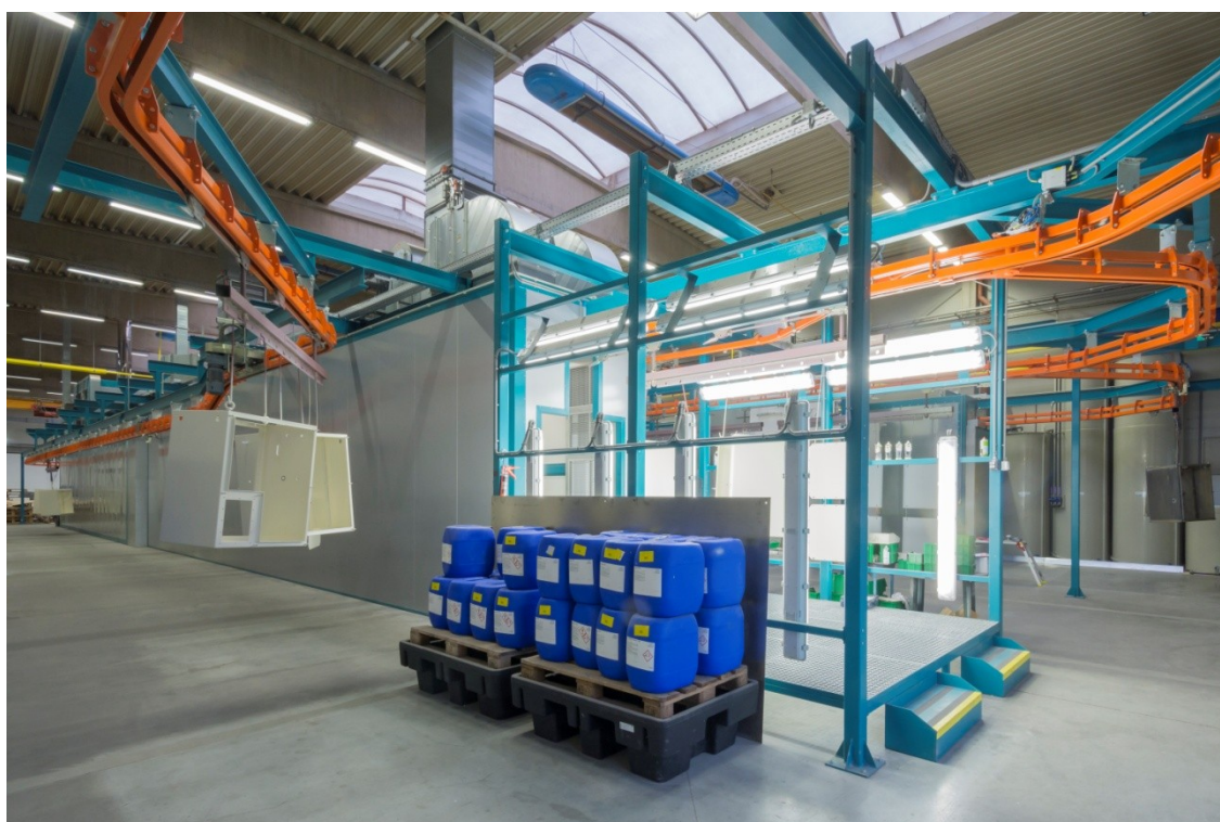
Obr. 27. Prostory lakovny ve výrobní hale společnosti ESB Rozvaděče, a.s.
