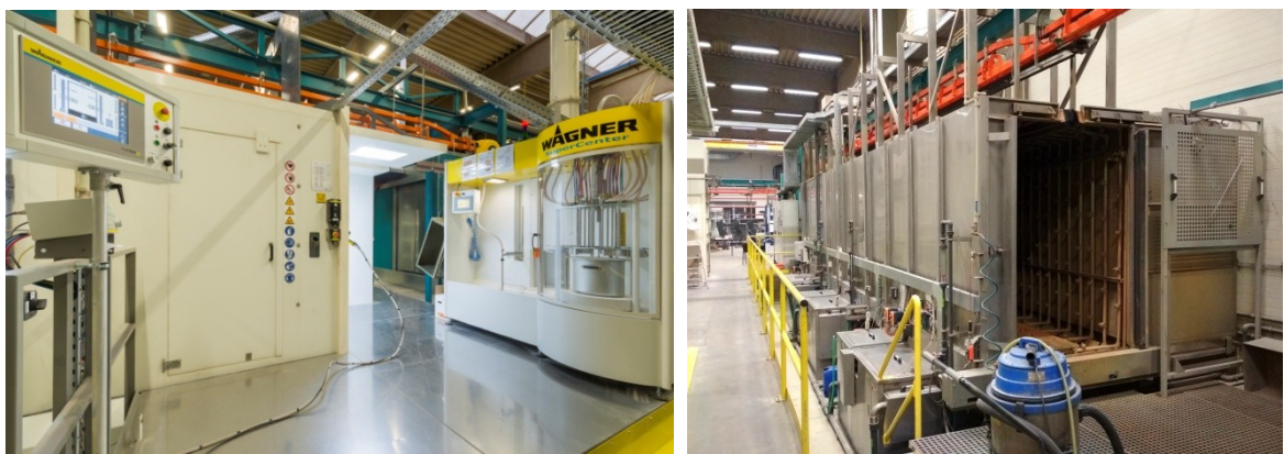
Obr. 41. Prostor v okolí linky (vlevo – pohled na práškovací kabinu, vpravo – pohled na „sprchu“)
