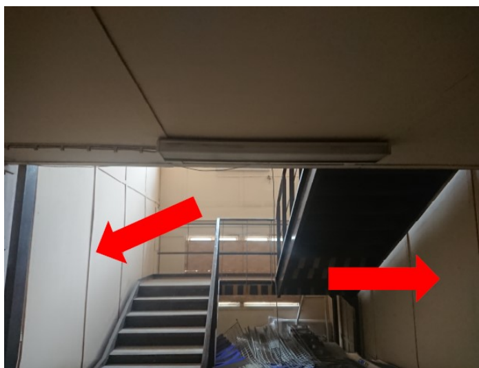
Obrázek 5 – Azbestové obkladové desky v prostoru schodiště [23]
