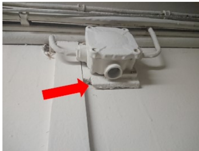
Obrázek 7 – Azbestové podložky pod elektroinstalací [23]
