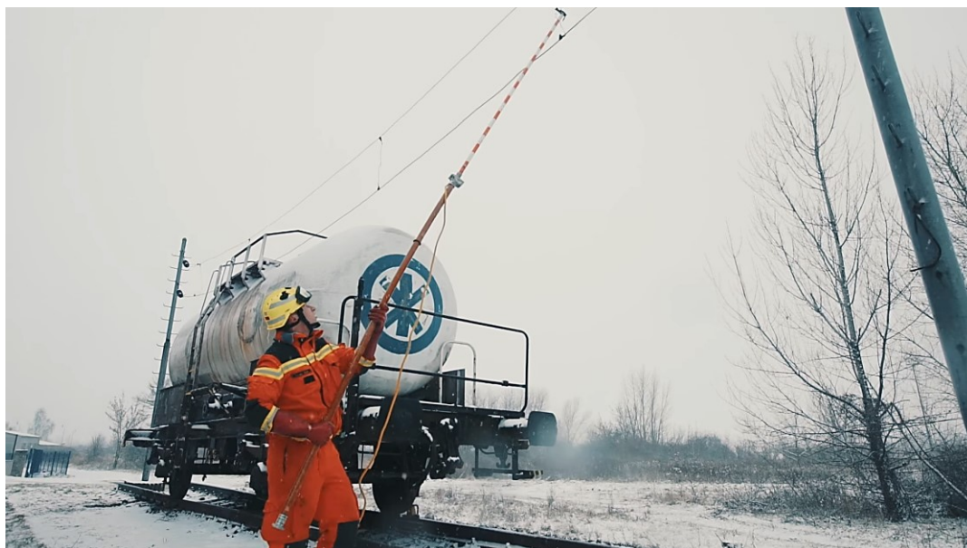
Obr. 22. Zkratování trakčního vedení. [46]
