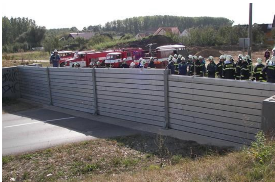
Obr. č. 22 – Mobilní zábrany spojující protipovodňovou hráz [49]
