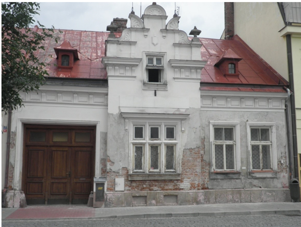
Příloha P II: Obrázek č. 3: Venkovní fasáda měšťanského domu čp. 1084 před rekonstrukcí
