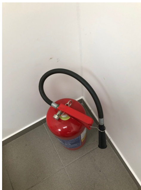
Obr. 13. Nezabezpečený hasicí přístroj [vlastní]
