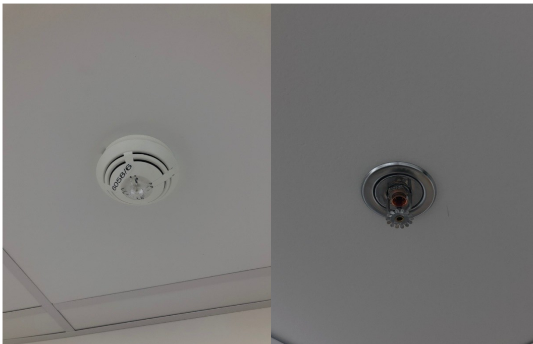
Obr. 8. Nainstalovaný automatický opto-kouřový hlásič a protipožární tryska [vlastní]
