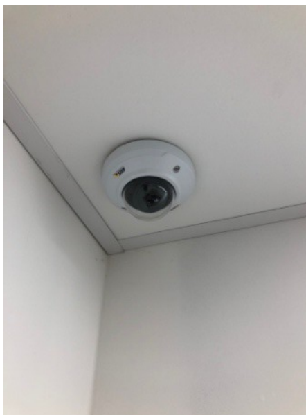
Obr. 4. Kamera instalovaná v servisním prostoru [vlastní]
