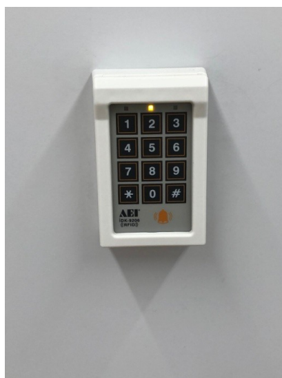
Obr. 9. Kódový zámek u dveří do skladu [vlastní]
