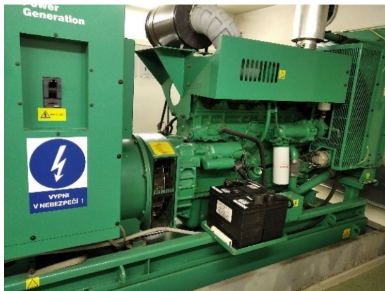
Obr. 8 Záložní zdroj BRECLOVE (vlastní zpracování)
