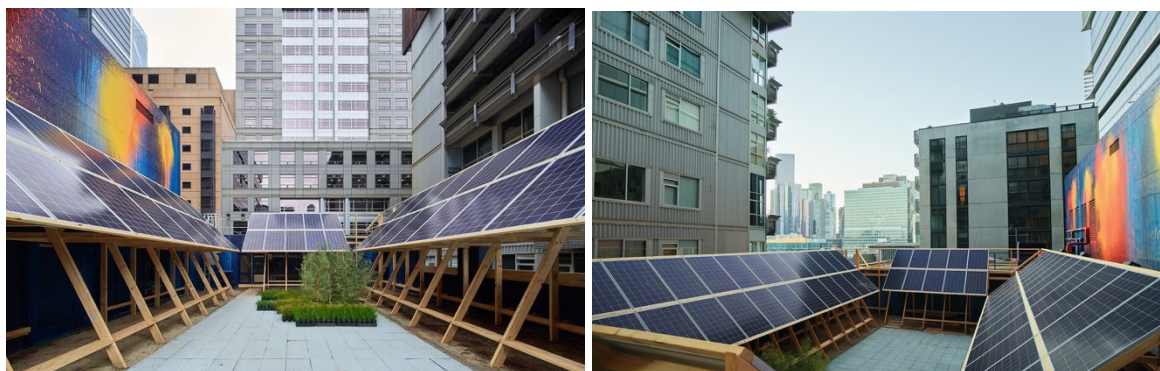
Obr. 18. Střešní infrastruktura pro solární energii
