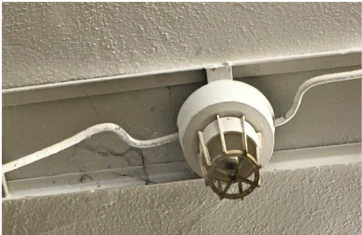
Obrázek 4 – Hlásič elektrické požární signalizace [vlastní]
