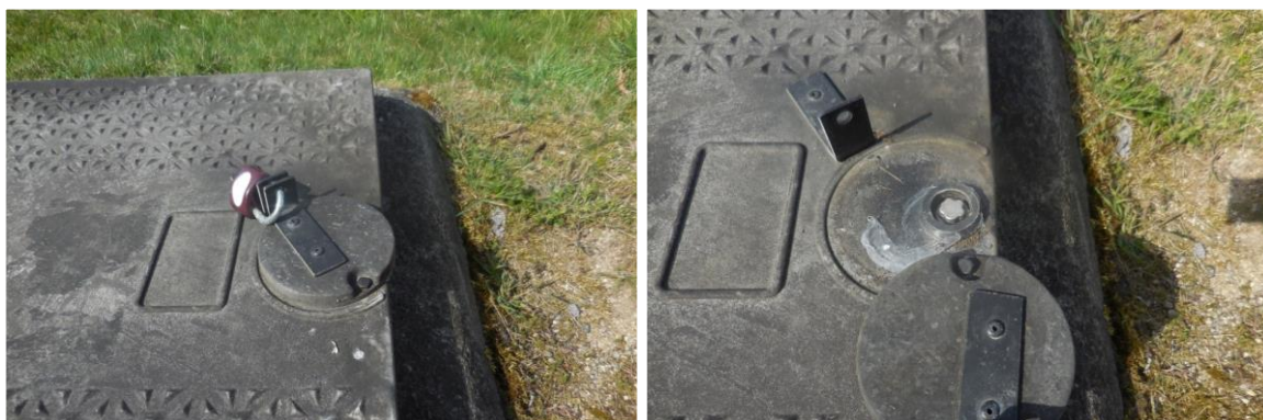
Obrázek 31: Pohled na zabezpečení poklopu. [Zdroj: vlastní]
