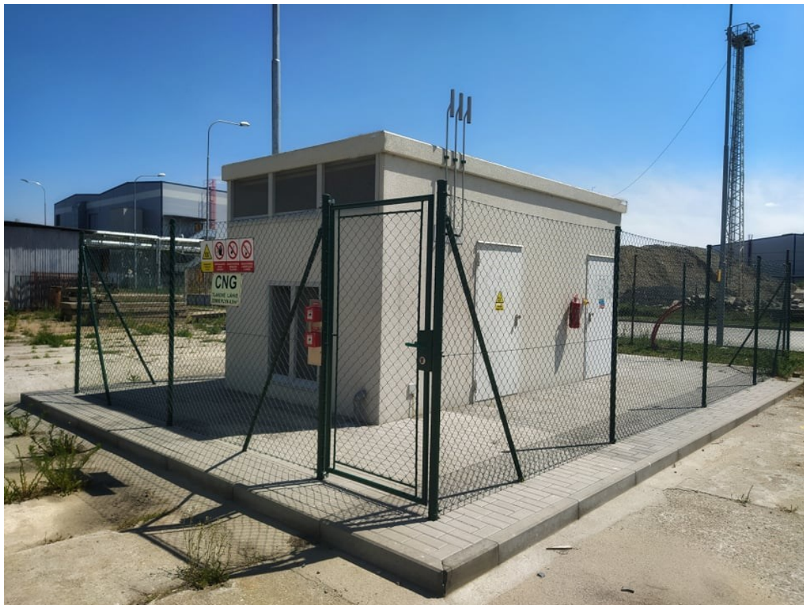
Obr. 29. Kontejner plnicí stanice CNG [autor]
