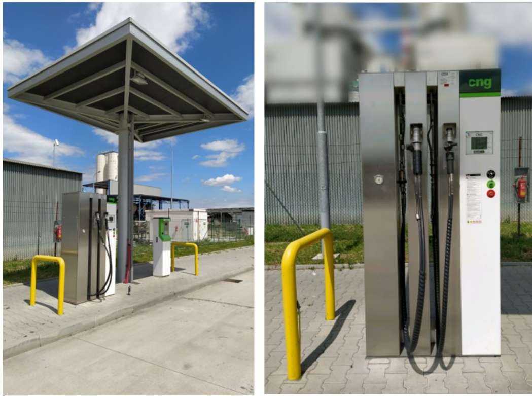
Obr. 34. Výdejní stojan CNG [autor]
