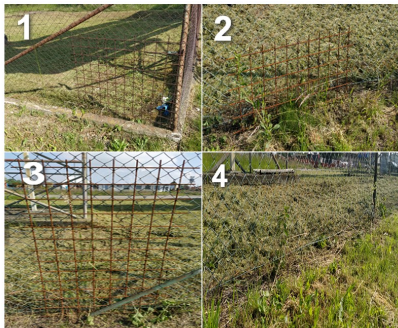
Obr. 23. Poškození oplocení objektu [autor]
