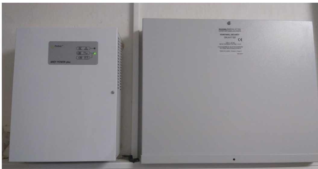
Obr. 5: Externí zdroj a ústředna PZTS v plechovém boxu [vlastní zdroj]
