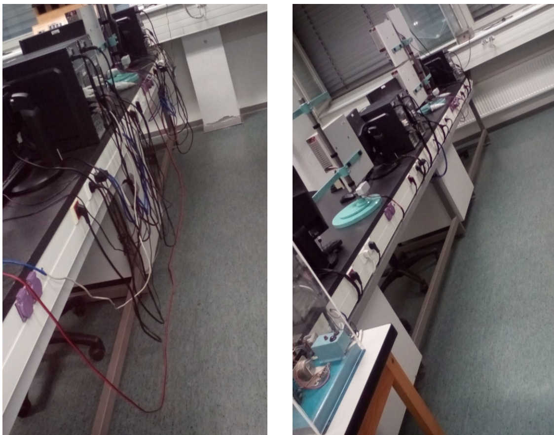
Obrázek 24: Vzhled kabeláže před a po uložení do žlabů
