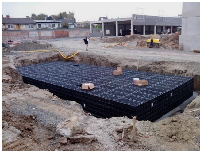
Obr. 47 Zasakovací nádrž umístěná pod parkovištěm v Otrokovicích ( www.pocitamesvodou.cz ).
