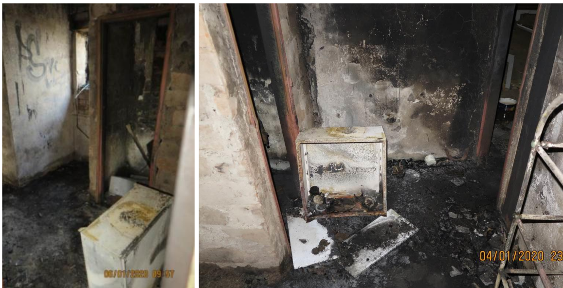
Obrázek č. 19. Pohled do místnosti provizorního spaní, prostoru kriminalistického ohniska požáru (Tulach, 2020)
