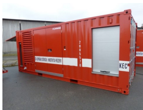
Obrázek 19 – KEC 400 (KEC 400 / 88 – elektrocentrála – kontejner, © 2022)
