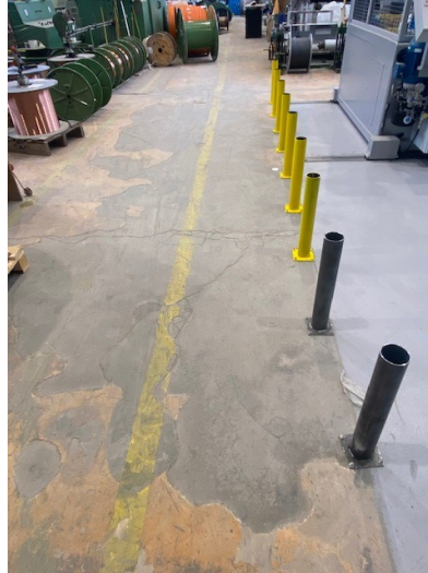
Obrázok 17 Bezpečnostné zábrany a neaktuálne podlahové značenie (vlastná fotodokumentácia)
