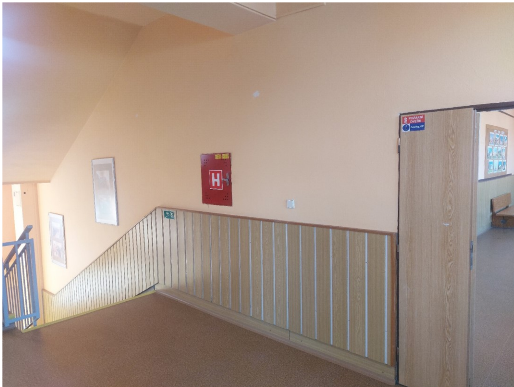
Obrázek 12 Otevřené požární dveře (vlastní)
