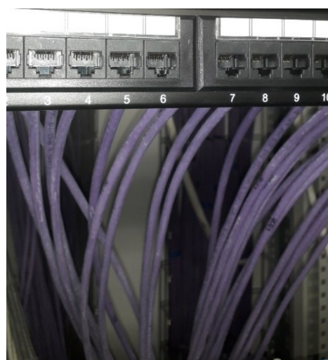
Obr. 19. Ukázka chybně vyvázané kabeláže v racku
