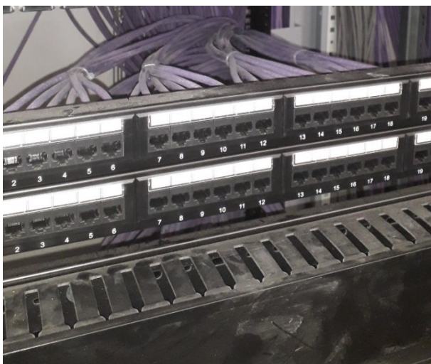
Obr. 20. Ukázka dobře vyvázané kabeláže v racku
