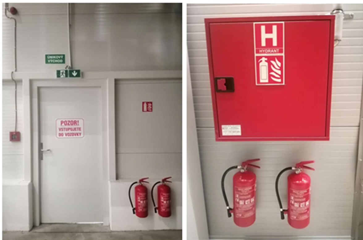
Obrázek 22 - Únikový východ, hasící přístroje a hydrant (vlastní)
