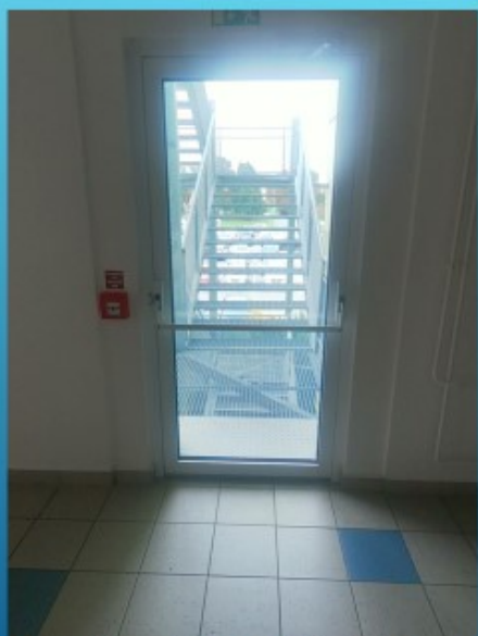
Obr. 6 – Nouzový východ (zdroj: vlastní)
