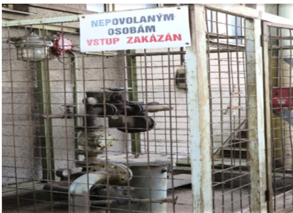
Obrázek 15. Přečerpávací stanice nafty, zdroj: autor
