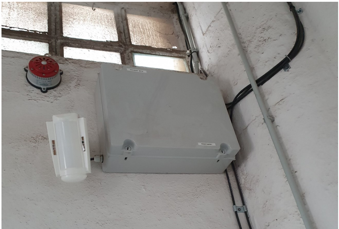
Obrázek 62. Instalace PZTS a ACS 5, zdroj: autor
