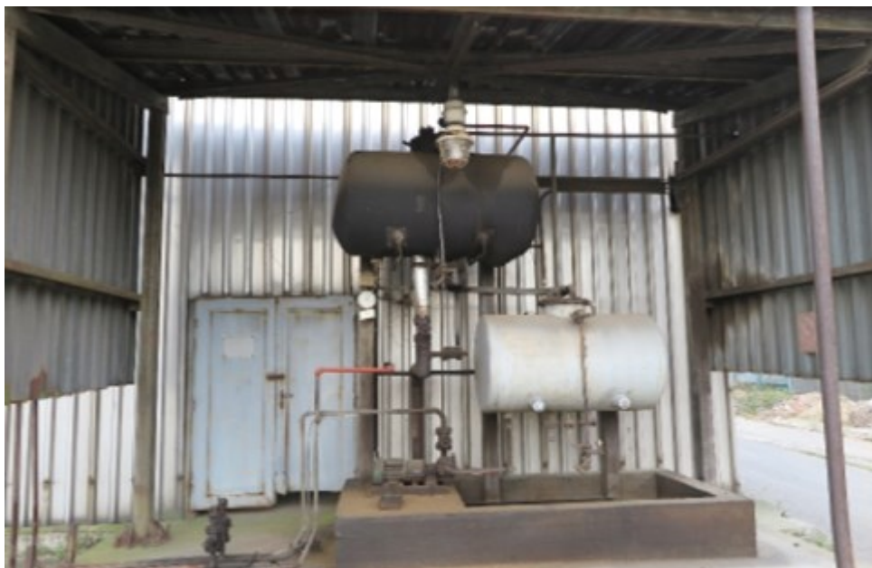
Obrázek 14. Přečerpávací stanice LTO, zdroj: autor
