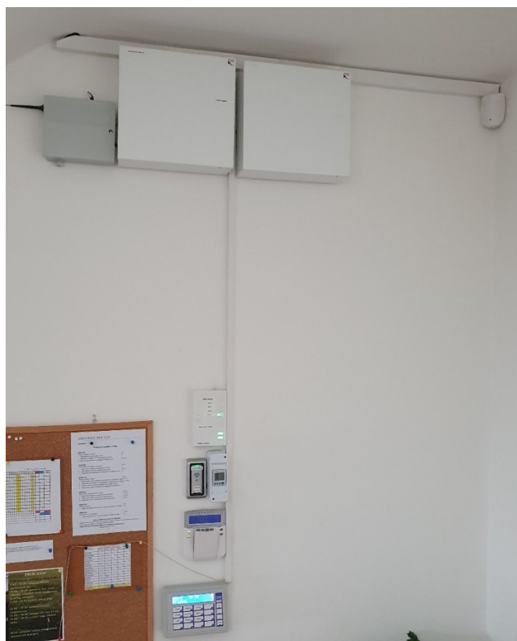
Obrázek 58. Instalace PZTS a ACS 1, zdroj: autor
