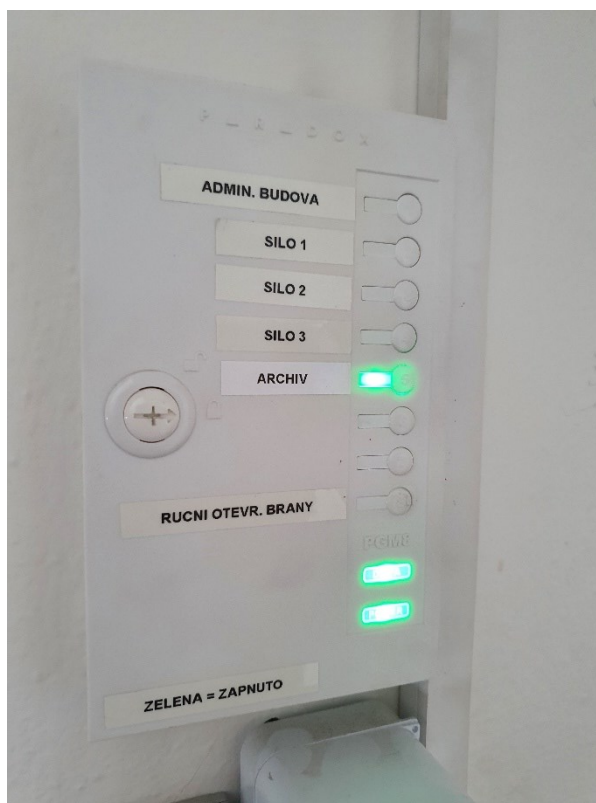
Obrázek 60. Instalace PZTS a ACS 3, zdroj: autor
