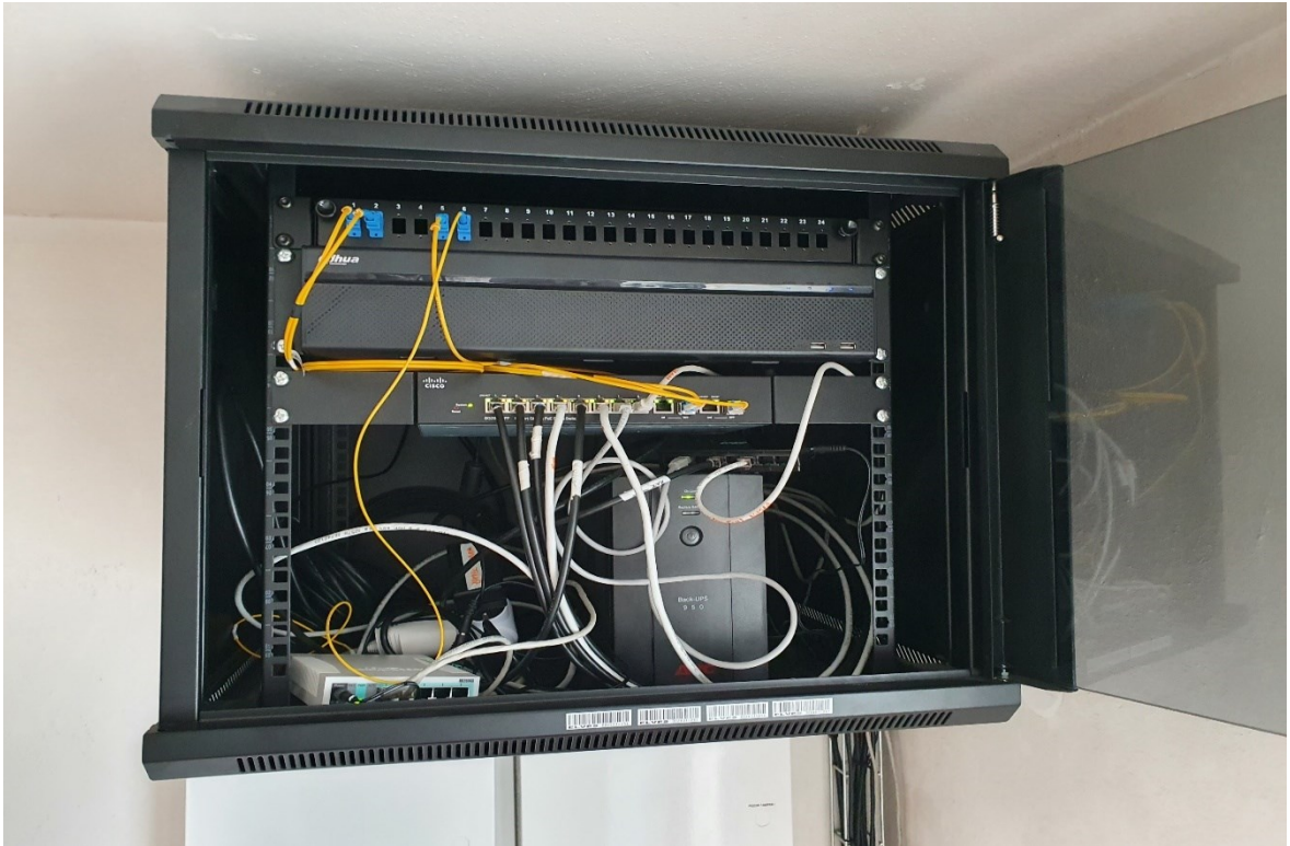
Obrázek 22. Rozvaděč – administrativní budova, zdroj: autor
