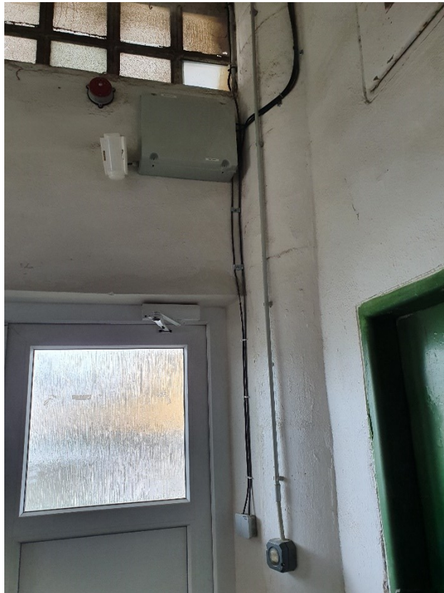
Obrázek 61. Instalace PZTS a ACS 4, zdroj: autor
