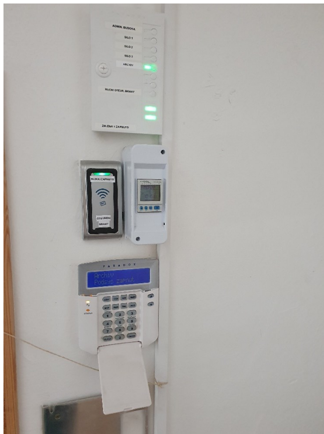
Obrázek 59. Instalace PZTS a ACS 2, zdroj: autor
