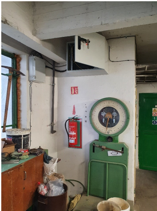
Obrázek 65. Instalace PZTS a ACS 7, zdroj: autor
