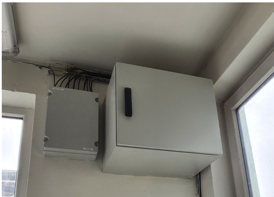
Obrázek 27. Rozvaděč – silo 3, zdroj: autor
