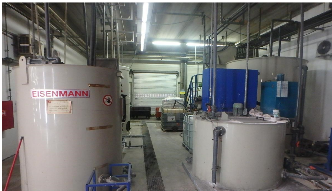
Obrázek 11 Čistička odpadních vod (zdroj: vlastní fotografie podniku Fritzmeier s.r.o. Vyškov)
