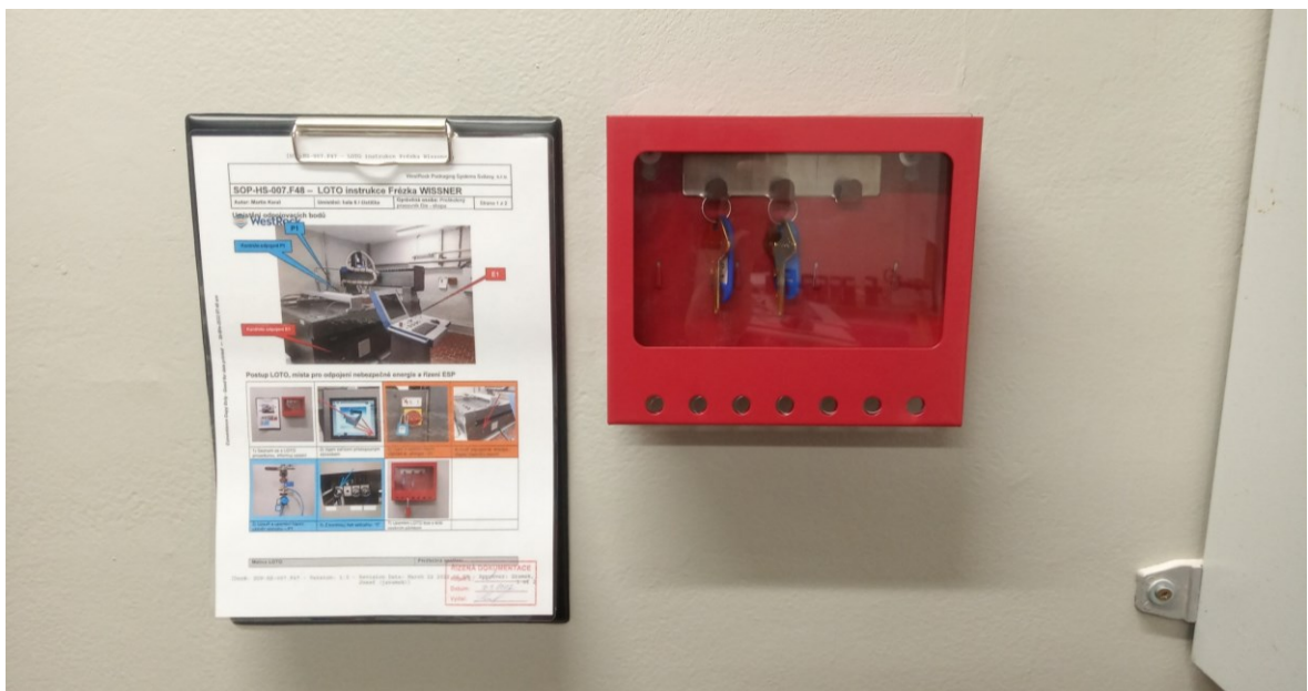
Obrázek 20: LOTO panel s instrukcemi (vlastní zpracování)
