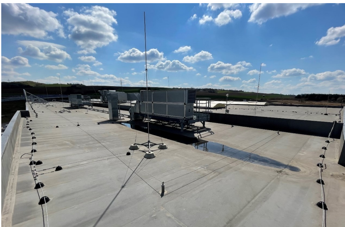
Obrázek č.14 Technologie umístěné na střeše objektu
