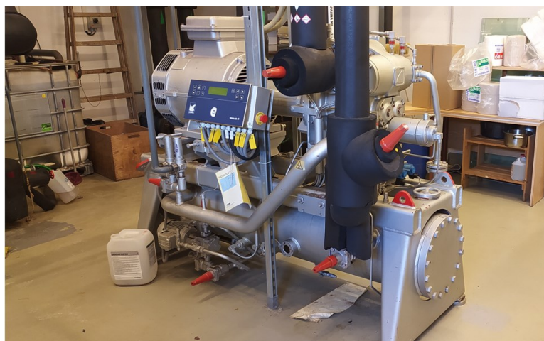
Obrázek 11 Pístový kompresor GEA Grasso, typ RCU 810 (Reciprocating compressor units – pístový kompresor)
