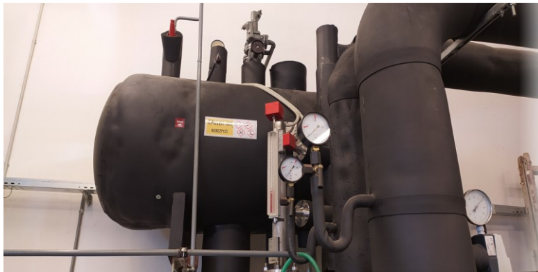
Obrázek 10 Zásobník čpavku ve strojovně
