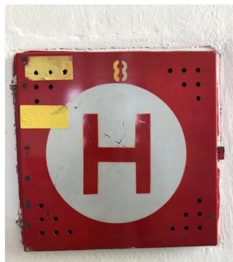
Obrázek 10 - Požární hydrant (vlastní)
