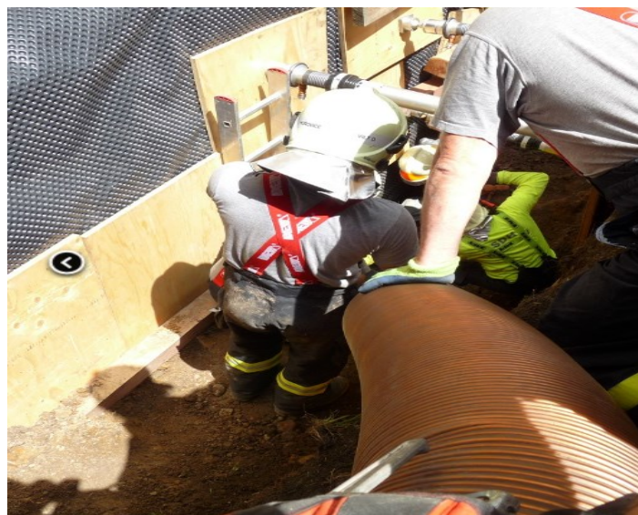
Obrázek 16 Sací bagr Hořovice (Tragický zával osoby ve výkopu v Hořovicích, © 2023)
