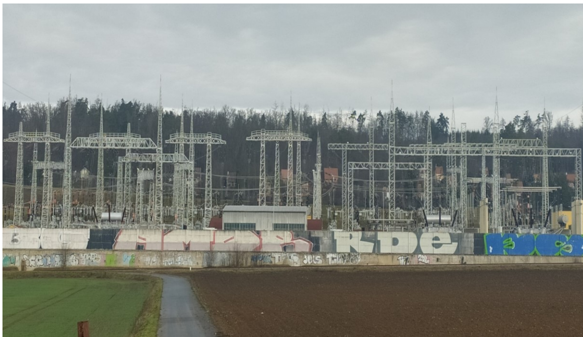
Obr. 7 Rozvodna Čebín, okres Brno-venkov (distribuce pro město Blansko)
