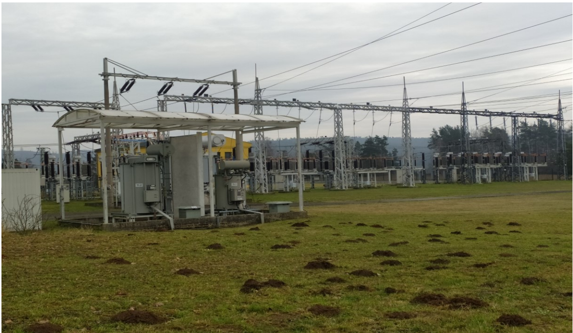
Obr. 8 Transformovna 110/22 kV ve městě Blansko
