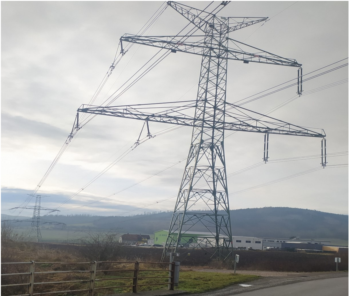
Obr. 4 Vedení přenosové soustavy v okolí obce Čebín typu Donau (okres Brno-venkov)
