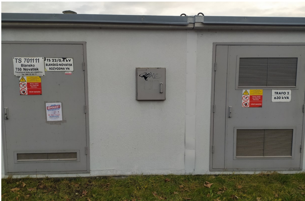
Obr. 9 Rozvodna VN 22/0,4 kV s transformátorem 630 kVA ve městě Blansko
