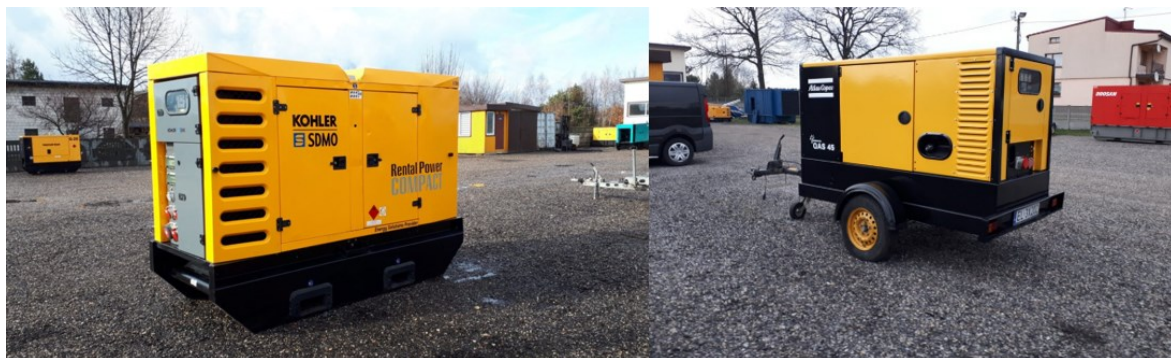
Obrázek 24 Diesel generátory (ESKO generator 2023)
