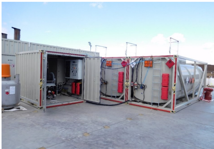
Obrázek 28 Kontejnerová čerpací stanice (Kobit 2023a)
