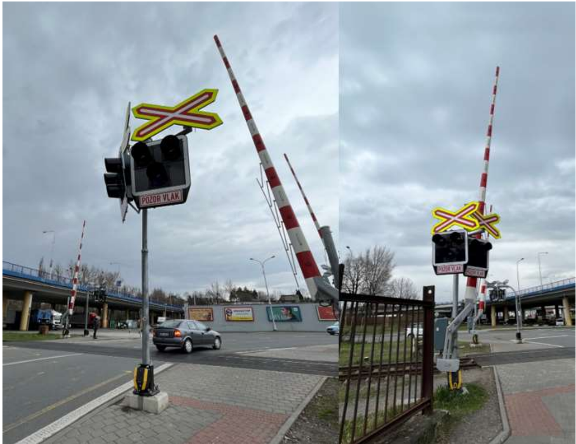
Obrázek 18 Světelná signalizace na přejezdu P7408
