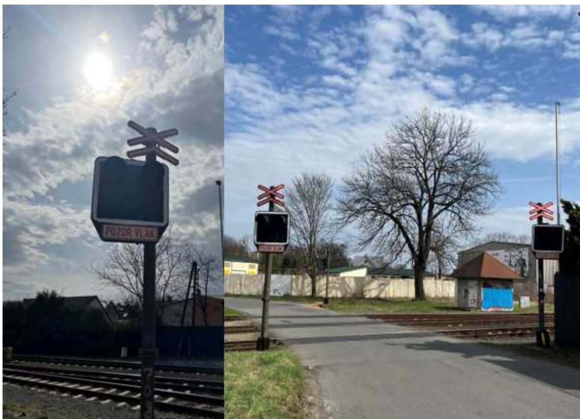
Obrázek 16 Světelné signalizační zařízení na železničním přejezdu P7396
