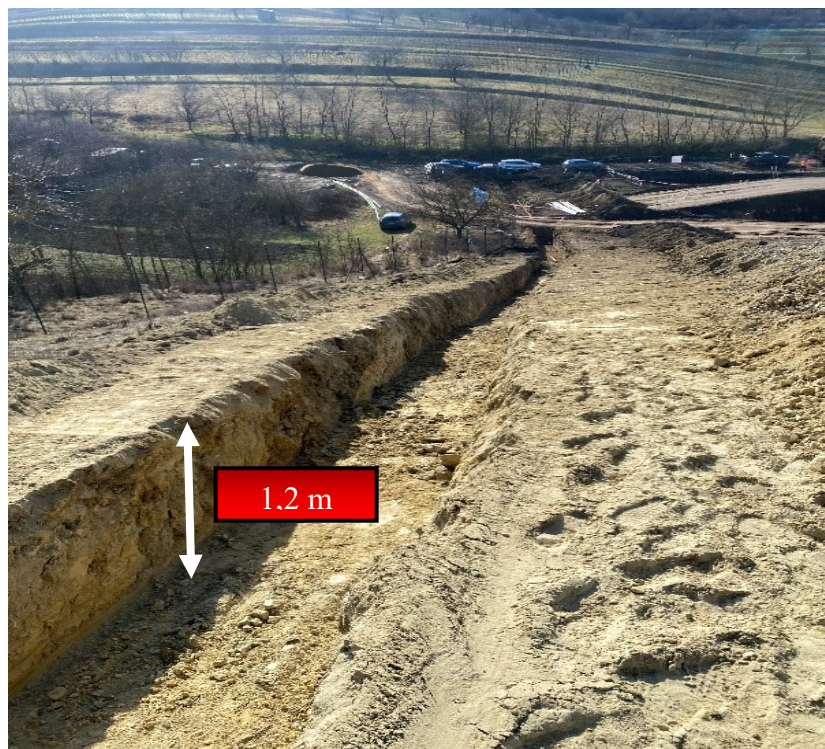
Obrázek 9 – Výkop nezajištěný proti pádu osob (zdroj: vlastní)
