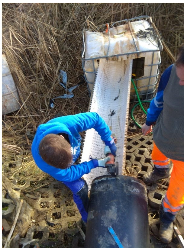
Obrázek 10 – Dělníci nevyužívající prostředky k ochraně očí a nedodržující bezpečnostní vzdálenost (zdroj: vlastní)
