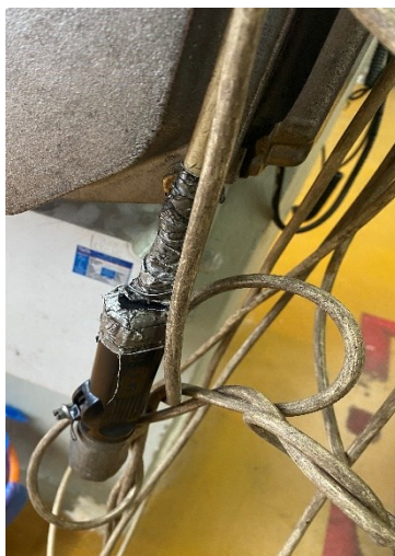
Obrázek 16. Porušená izolace kabeláže [vlastní]
