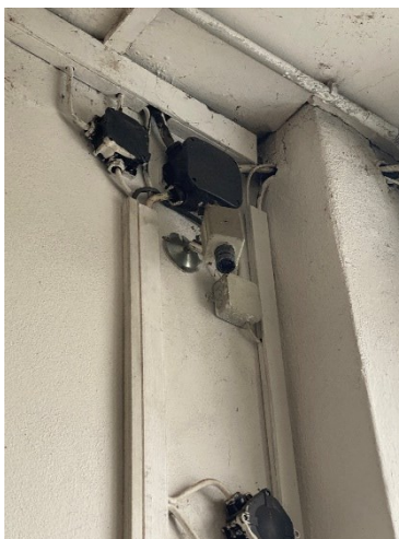
Obrázek 24. Nefunkční kamera v budově emisní kontroly [vlastní]
