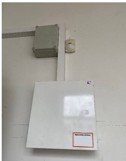
Obrázek 21. Ústředna budovy emisní kontroly a PIR detektor [vlastní]
