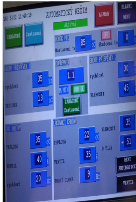
Obrázek 12 Ovládání dopravníku [vlastní]
