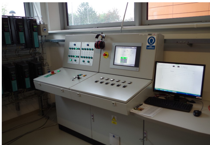
Obrázek 44 Kontrolní panel pro měřicí trať
