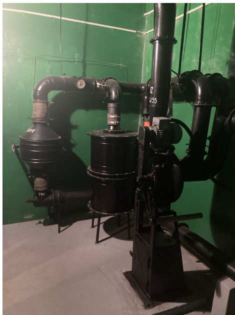
Obrázek 6 – Filtro-ventilační zařízení na Holečkově základní škole ze strany (vlastní)
